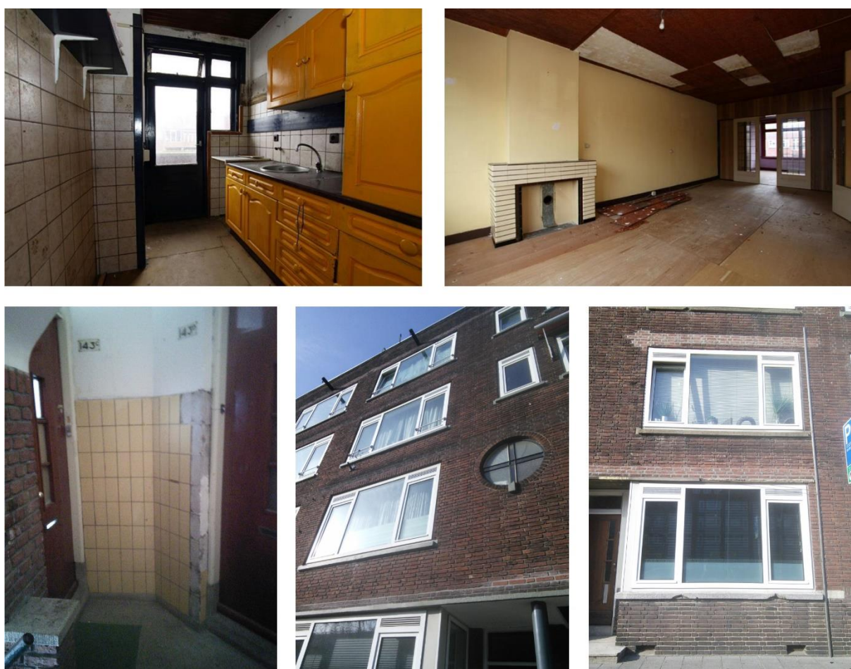
Figuur 7 Fotomateriaal van de staat van de woningen op de Pleinweg. Van boven naar beneden en van links naar rechts: de keuken en de woonkamer van de woning op Pleinweg 174a. Bron: Funda.nl. Foto van het portiek en de voorgevel. Bron: eigen materiaal.
